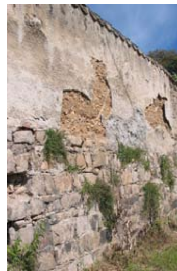
Combinaison des désordres
