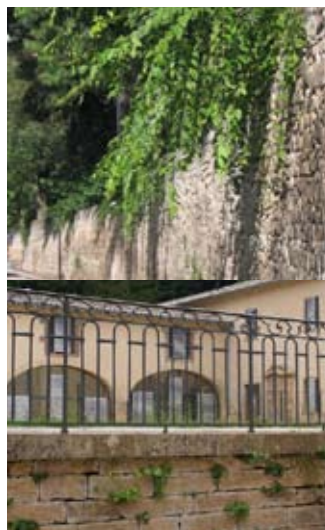
Présence de végétaux sur les murs
