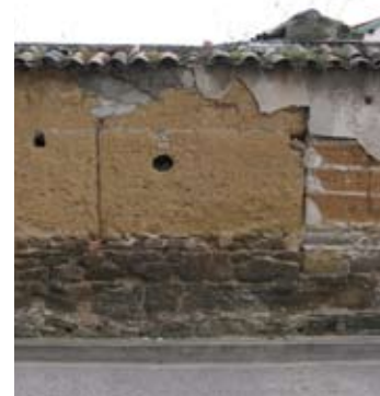
Décrochement des enduits
